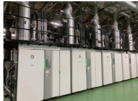
ボイラ設備(大樹工場)
