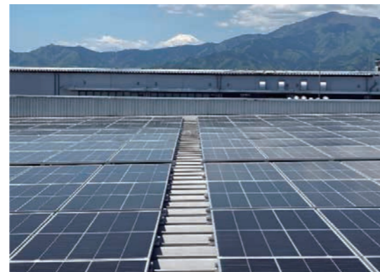
太陽光発電設備(海老名工場)
