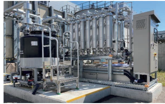
ろ過逆洗水回収設備 (海老名工場)
