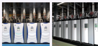
ボイラ(札幌工場) ボイラ(福岡工場)
