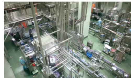
海老名工場2ライン(奥側1号機、手前2号機)
