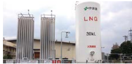
沖縄名護工場のLNG設備
