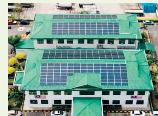
ISFの太陽光パネル
