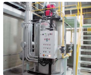
▲ 水島工場の精製高圧ボイラー
