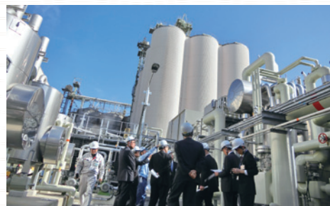
千葉工場 オンサイト発電所
