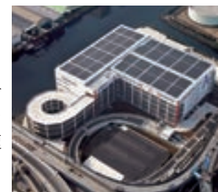
物流センター屋上に設置された太陽光パネル (ASKUL Logi PARK 横浜)
