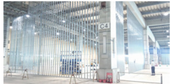
双日建材が総販売元として独占使用权を有するグリッドウォール工法の施工例
