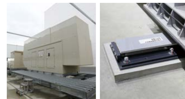
物流センターの自家発電装置
