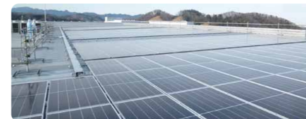
キューピータマゴ飯能工場の太陽光発電設備
