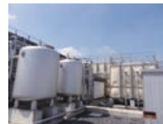
久喜工場の取水施設
