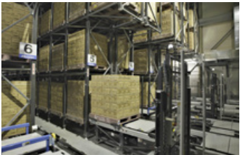
自動倉庫内部
