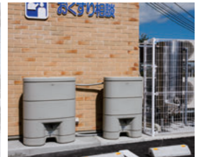
クオール薬局加西店 雨水貯留タンク
