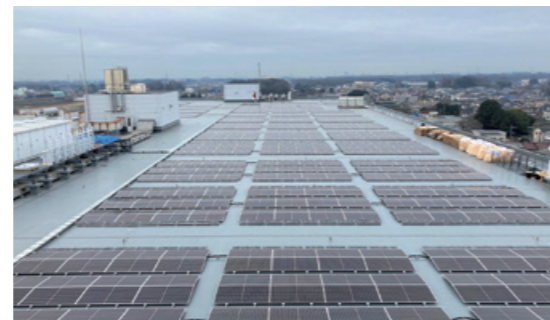
三越伊勢丹物流センター屋上でオンサイトPPAによる太陽光発電
