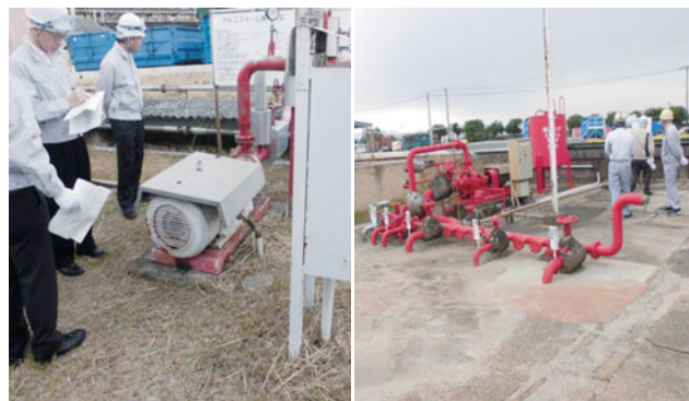
第三者による防災設備診断
