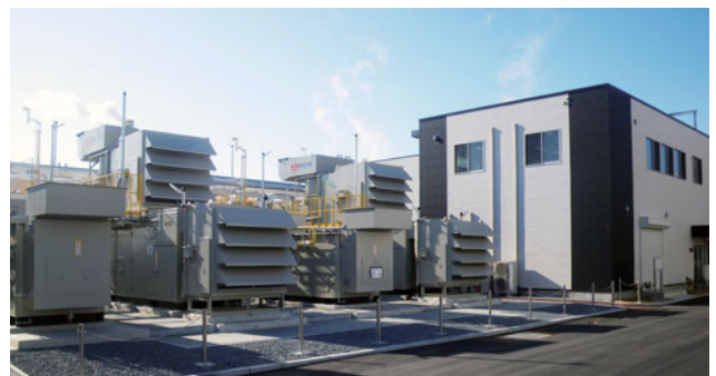
日本エクスラン工業(株)のガスコージェネレーション設備
