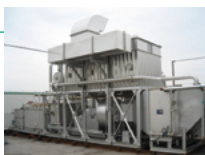
VOC回収装置
