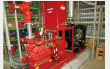
電動モータ・エンジン消火栓ポンプ
