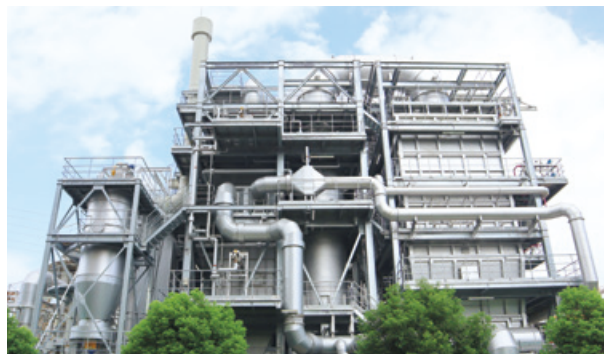
バイオマスボイラ設備
