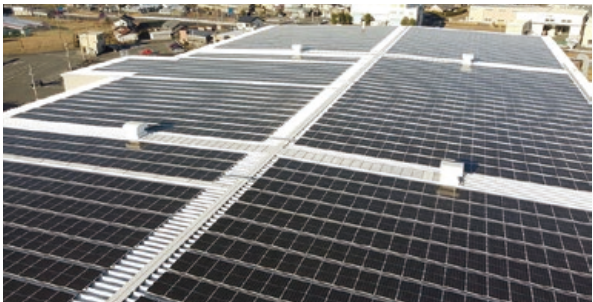
堤工場の太陽光パネル
