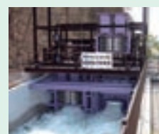
長野県梓川土基改良区穀納め小水力発電設備(発電規模約50kW)
