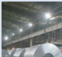
大規模工場向け高天井LED照明設備の導入を積極的に推進しております。
