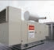
非常用発電機
