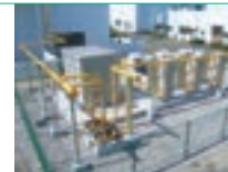
岡山県倉敷市殿納めバイオガス発電設備「くらげんき」
