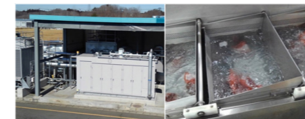
蓄氷冷却システム
