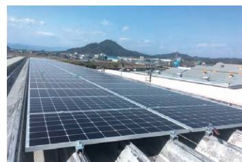
当社物流倉庫屋上の太陽光パネル
