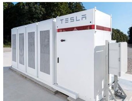
白井DCCに設置された 大容量リチウムイオン蓄電池
