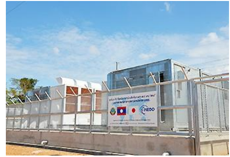
ラオス初の環境配慮型データセンター
