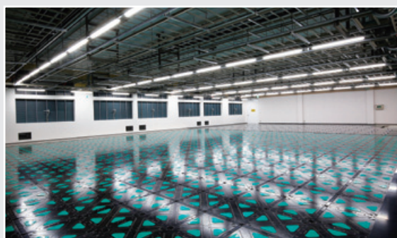
サーバルーム
