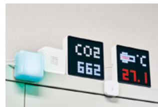
施設内に設置された温湿度センサー
