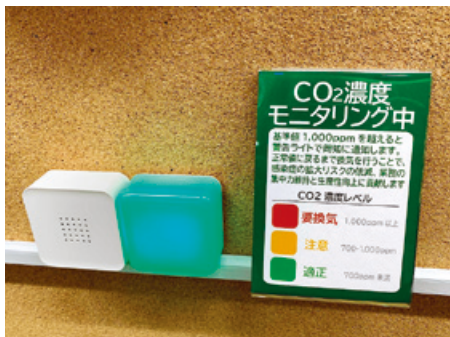
各会議室に設置されるCO 2 センサー
