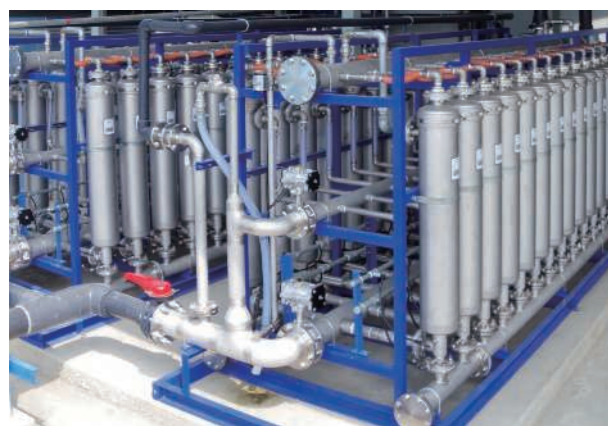
工業用水製造システム
