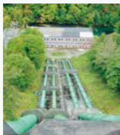
王子製紙苫小牧工場 千歳第一水力発電所
