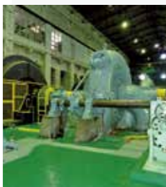
王子製紙苫小牧工場 千歳第一水力発電所内
