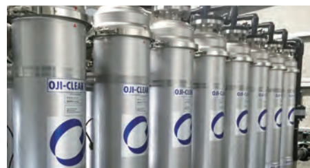
排水処理システム
