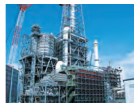
王子マテリア富士工場 バイオマスボイラ
