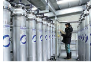
水産加工工場へ納入した膜処理設備
