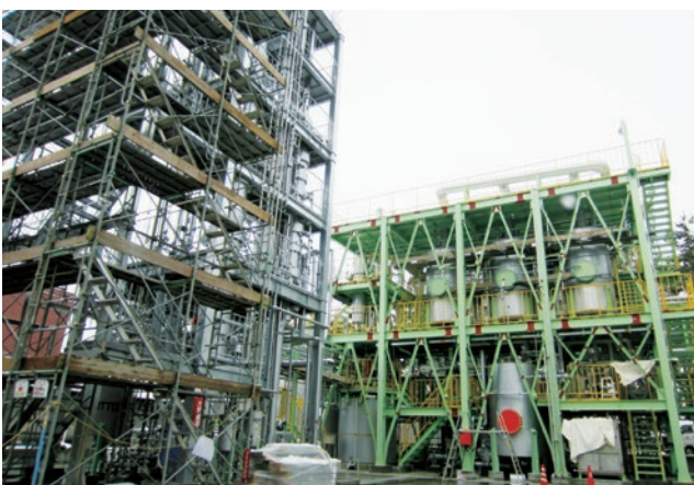
フルフラール実証試験設備
