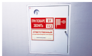
オフィス内に設置された消火設備
