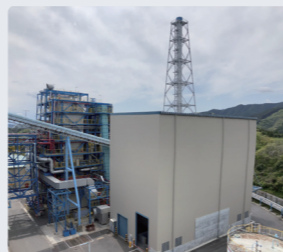
いわき リサイクルボイラー(5号ボイラー)
