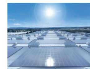
レンゴ(株)福島矢吹工場の太陽光発電設備
