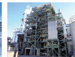
レンゴ(株)八潮工場の木質チップバイオマス発電設備
