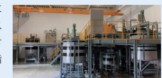
RCNFパイロットプラント
