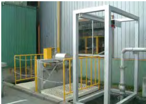
水質監視設備 (小山事業所)
