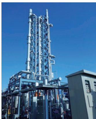
CO 2 回収実証試験設備
