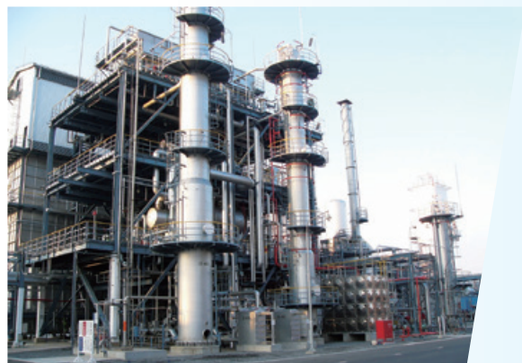
イソシアネート原料生産設備（COプラント）
