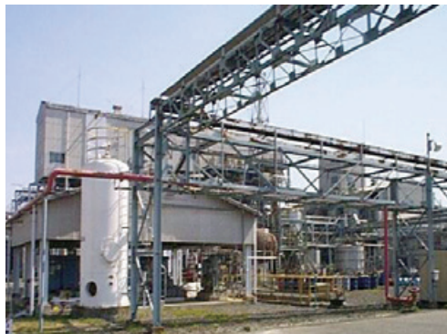
▲ポリエチレン製造設備
