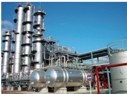
▲塩化ビニルモノマー製造設備
