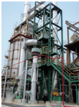
▲キュメン製造設備
