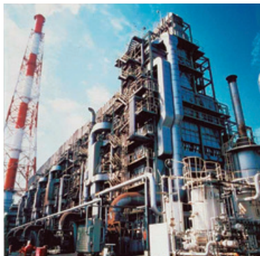
▲エチレン製造設備
