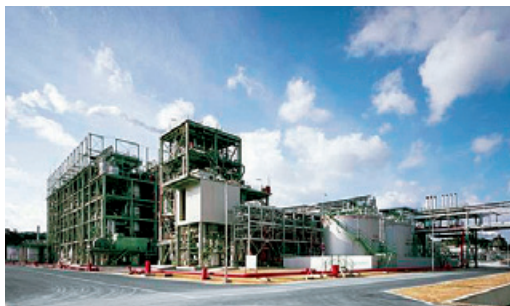
▲MDI製造設備
