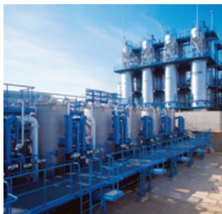
▲下排水高度処理設備
