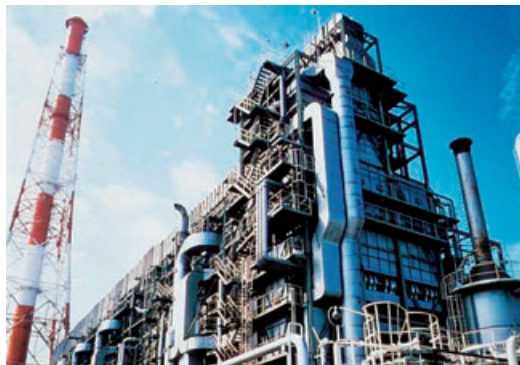
▲エチレン製造設備
