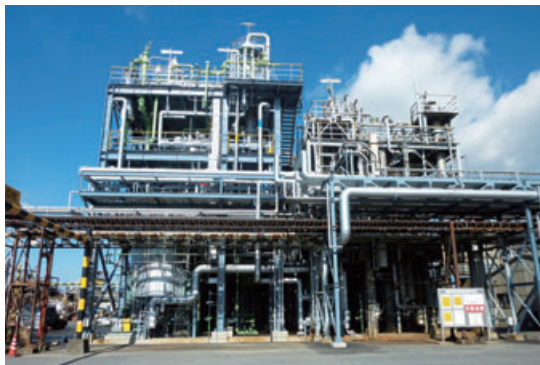
▲クロロスルホン化ポリエチレン製造設備
