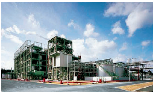
▲MDI製造設備
