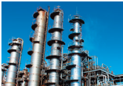
▲第三塩化ビニルモノマー製造設備
