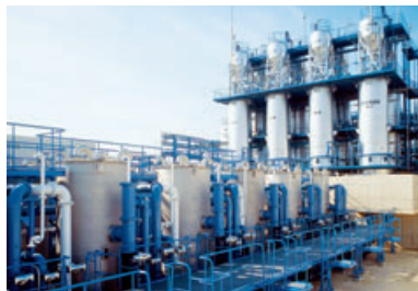
▲下排水高度処理設備
