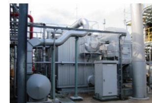
松山工場 水素ボイラー
