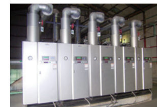
尼崎工場 都市ガスボイラー
