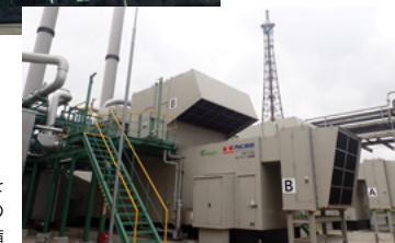
2022年に運転を開始した千葉工場の高スタービン発電設備
