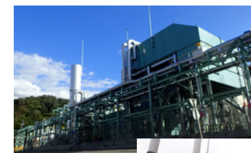
2020年に運転を開始した青海工場の高スタービン発電設備
