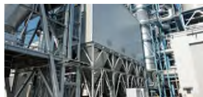
ボイラ燃焼ガスの有害物質を除去するバグフィルタ
