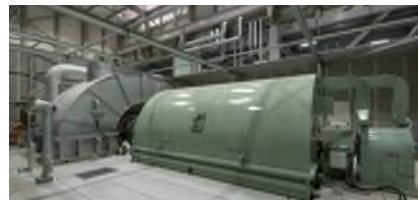
蒸気タービン・発電機
