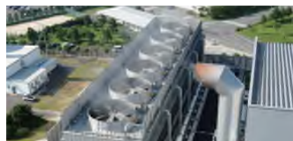
佐波川から取水した工業用水を利用した冷却塔
