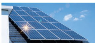
クリーンな電気をつくる太陽光発電システム
