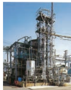
ローダミン 製造設備
