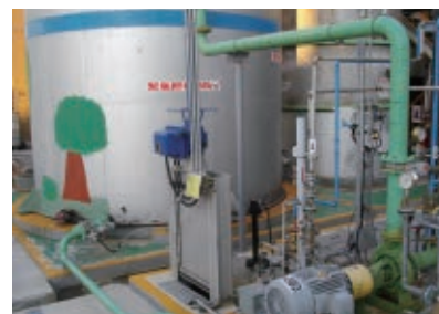
緊急時排水回収設備
