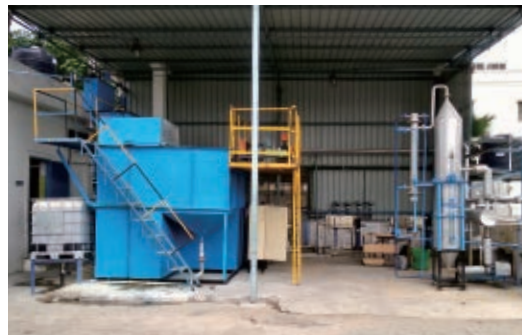
排水処理設備
