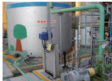
緊急時排水回収設備
