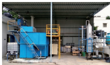
排水処理設備
