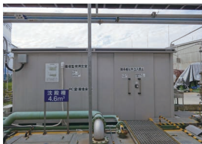
環境監視測定室
