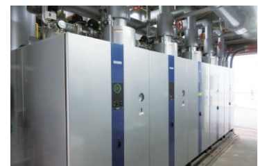
播磨工場蒸気ボイラーを高効率設備に更新
