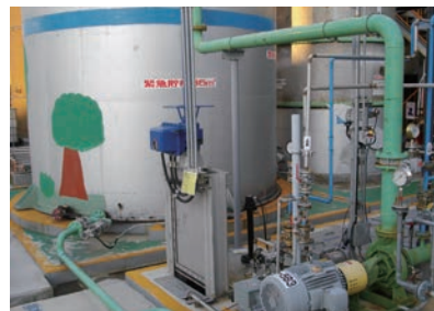
緊急時排水回収設備
