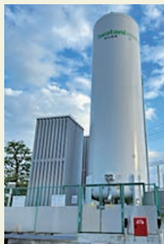
播磨工場 液体窒素受け入れ設備
