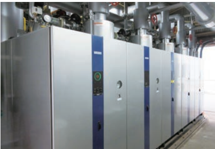
高効率設備に更新された淀川工場の蒸気ボイラー。 (※) 設備ごとに排出濃度規制値が定められておりますが、いずれも規制値を充分に下回っております。
