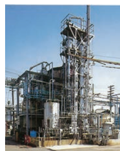
ローダミン 製造設備
