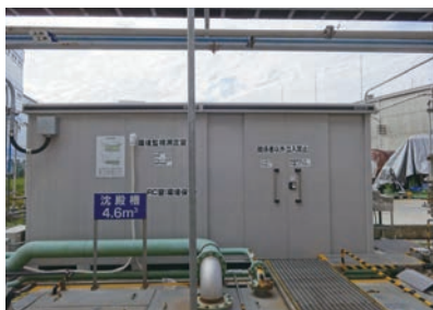
環境監視測定室
