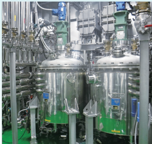
新設した次世代半導体向け設備の一部
